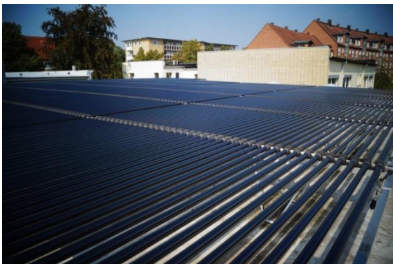
Dünnschicht-Röhren-Photovoltaikanlage © Andreas Kopp
