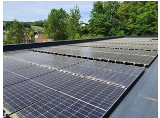
Hallendach mit Photovoltaikanlage © Die Tischlerkenten
