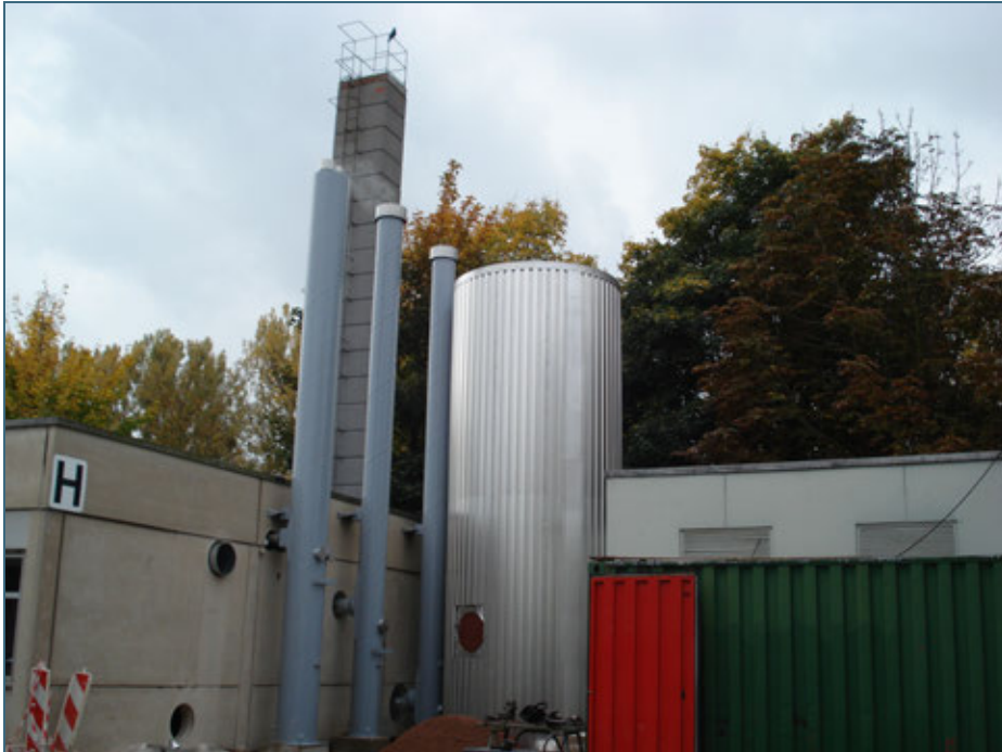
Abb. 21: Heizwasserpufferspeicher mit 50 m 3 Inhalt
