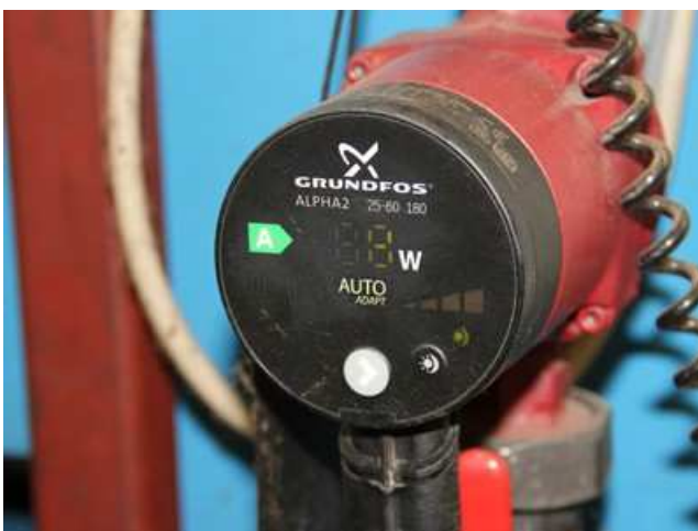
Modernisierung der Heizungsanlage – Austausch der Umwälzpumpen - © Maschinen und Formenbau Leinetal MFL GmbH
