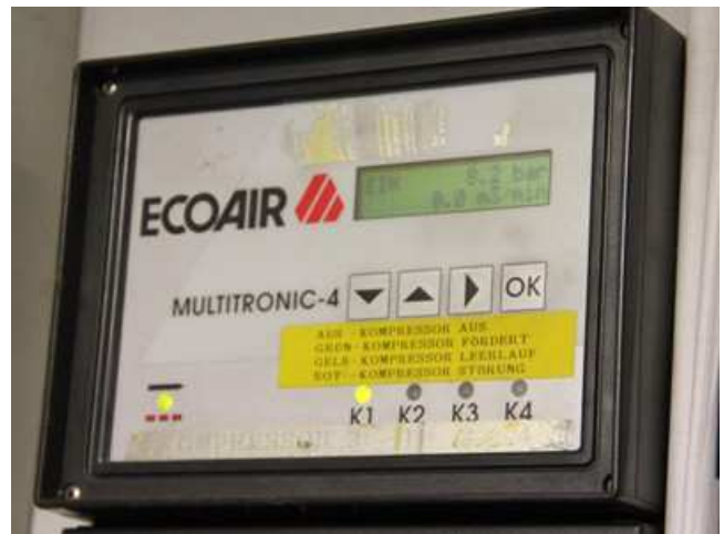
Bedarfsgerechte Steuerung der Kompressoren © Maschinen und Formenbau Leinetal MFL GmbH
