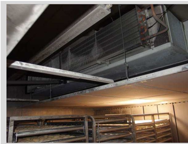
Gärkammer mit Heizung aus Abwärmenutzung © Handwerkskammer zu Leipzig
