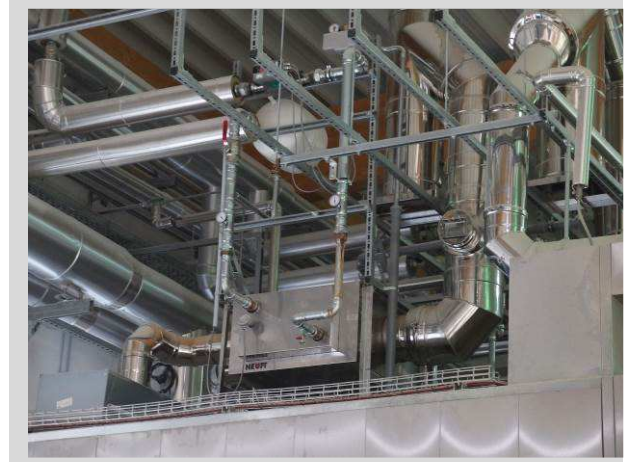
Absaugung und Umleitung des Schwad- und Rauchgases © Handwerkskammer zu Leipzig
