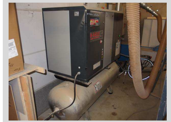
Druckluftkompressor neu © Handwerkskammer zu Leipzig
