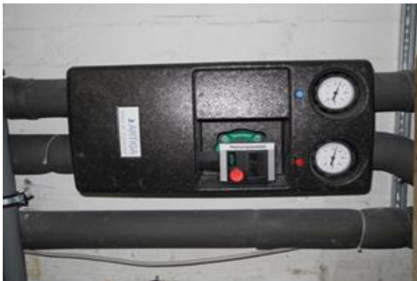
Vorbildlich gedämmte Heizungspumpe und Rohrsystem im Betrieb Bußmann; © Handwerkskammer Münster
