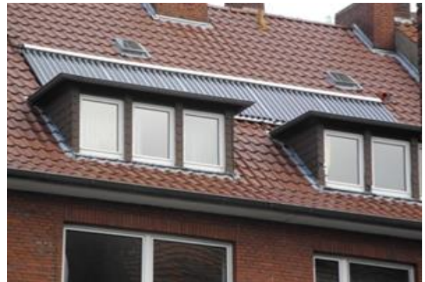
Solaranlage zur Brauchwassererwärmung im Friseurbetrieb Bußmann ; © Handwerkskammer Münster
