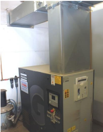
Kompressor mit Wärmerückgewinnung © Handwerkskammer Hamburg
