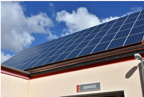
Photovoltaikanlage Werkstatt © Handwerkskammer zu Leipzig
