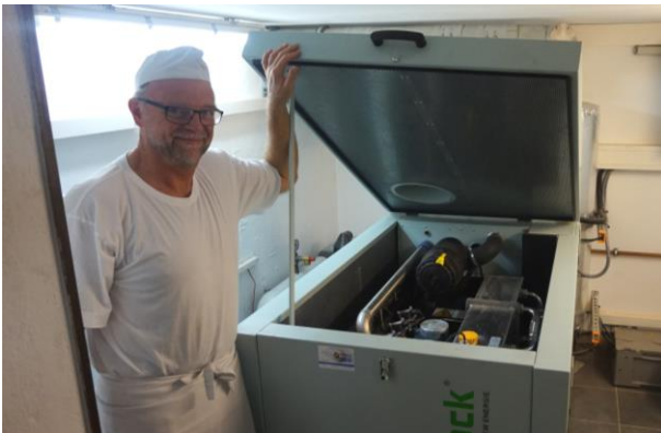
Das neue (2017) Flüssiggas-Blockheizkraftwerk der Bäckerei Eberl © Dirk Bräu, Handwerkskammer für München und Oberbayern
