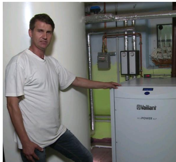
BHKW und Pufferspeicher © VKU Verband kommunaler Unternehmen e.V.
