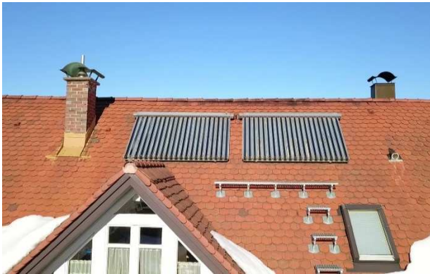
Röhrenkollektoren zur Unterstützung der Warmwasserbereitung © M. Tröbelsberger
