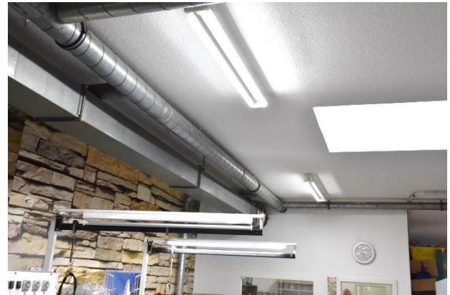
Bestandsanlage mit LED Tubes
