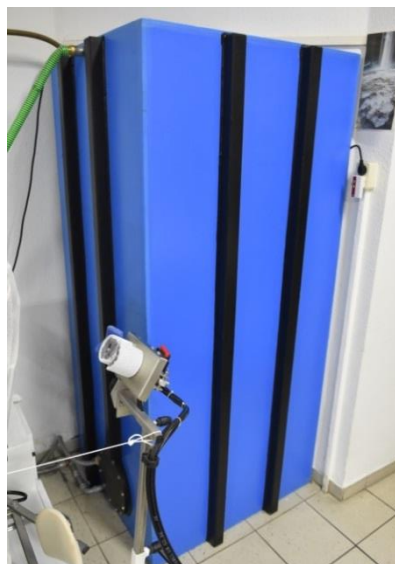
In Raumecke eingepasster 700 Liter Tank aus PE mit dreieckiger Grundfläche
